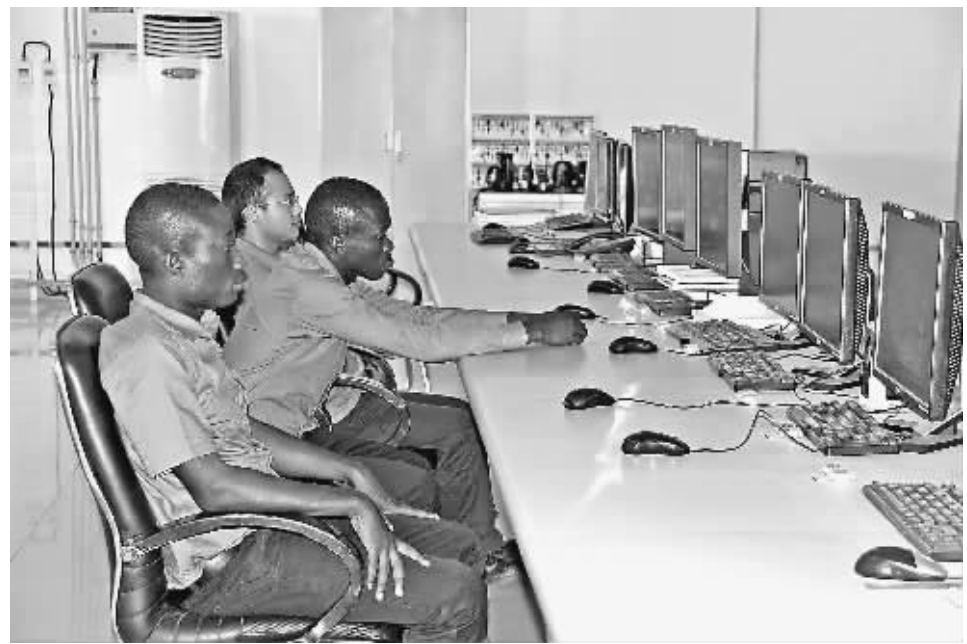
图为博恩电厂监控中心的中国与加纳员工。
